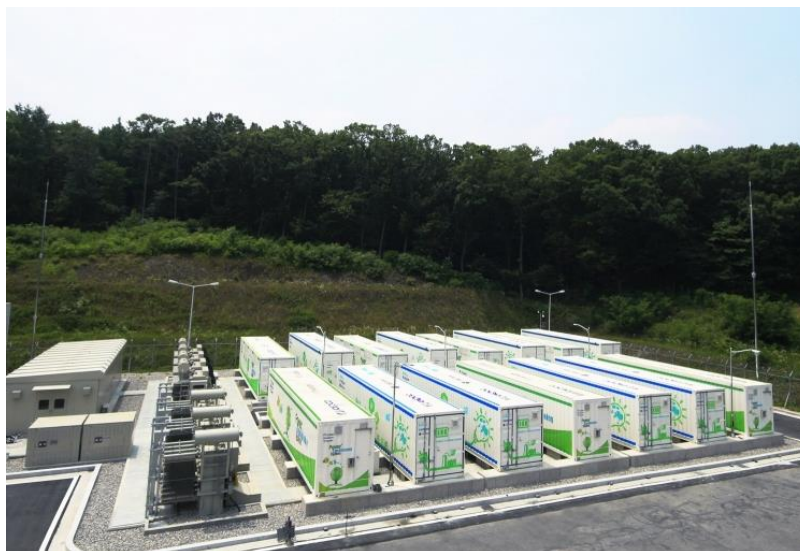
26. ÁBRA: 56 MW-OS AKKUMULÁTORTELEP KOREÁBAN
